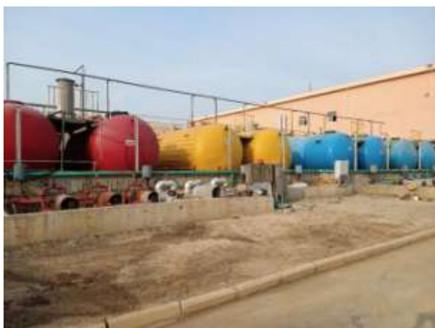
污水处理厂化学品罐区
